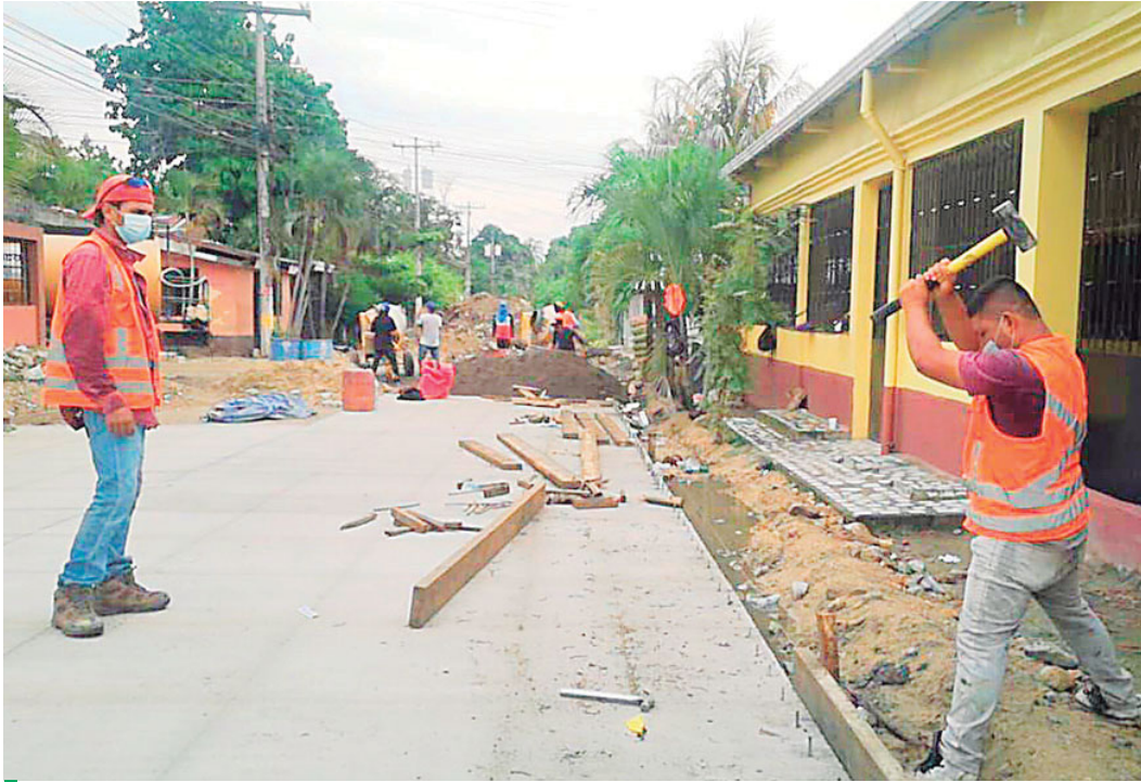
El barrio Morazán tendrá mejores calles y el acceso de los habitantes será más fácil con el proyecto de pavimentación.
