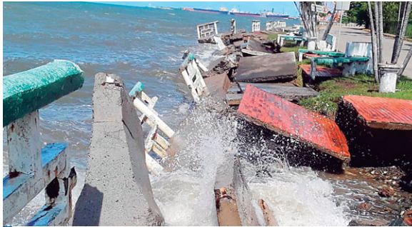
Desde años atrás la infraestructura del malecón se ha venido deteriorando.
