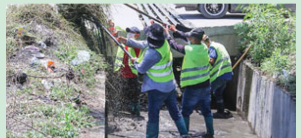
Los colaboradores municipales realizan los trabajos de limpieza para evitar que haya inundaciones en tiempo de lluvia.
