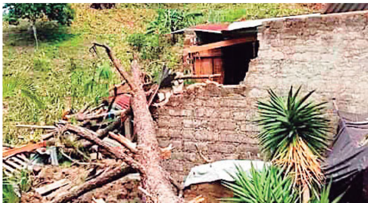
En el barrio Bellavista, del municipio de San Luis en Santa Bárbara los vientos huracanados dejaron algunas casas destruidas.
