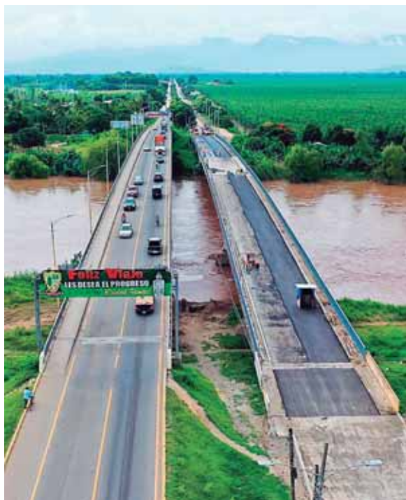
Este puente comunica a El Progreso con San Pedro Sula y otros sectores de la zona norte; resultó dañado casi en su totalidad por el terremoto que se produjo en el año 2009.
