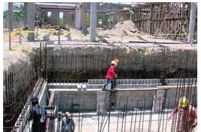
La próxima semana se comenzará con los trabajos de fundición de una parte de lo que es el piso del segundo nivel.
