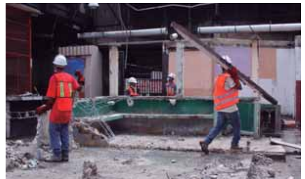
El siniestro generó daños en un 50% de la estructura del edificio y al menos 140 locatarios perdieron todo su patrimonio.
