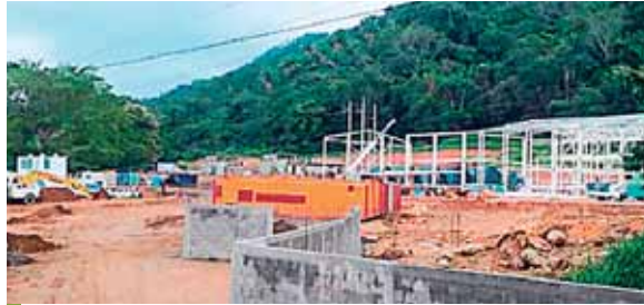
La inversión es realizada por la empresa LAEISZ en las plantas generadoras de La Ensenada para estabilizar el suministro energético en la zona.
