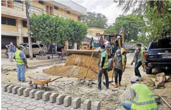
Los colaboradores municipales avanzan con los trabajos de adoquinado para que pronto haya mejor acceso en las colonias.
