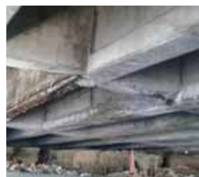
Los daños en las bases de la estructura son evidentes, vecinos temen una desgracia.
