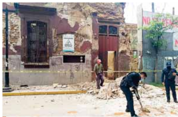
Policías y elementos de Protección Civil levantan parte de una barda derrumbada en la ciudad de Oaxaca (México).
