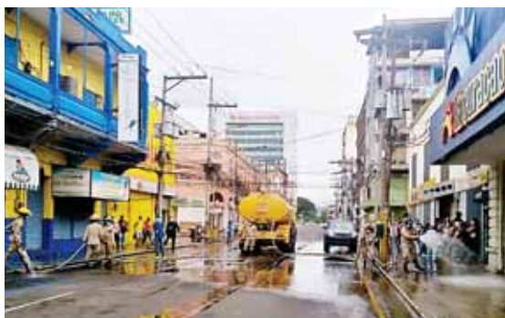
Realizaron labores de lavado y retiraron estructuras contaminadas como son madera, toldos y estructuras metálicas corroídas.
