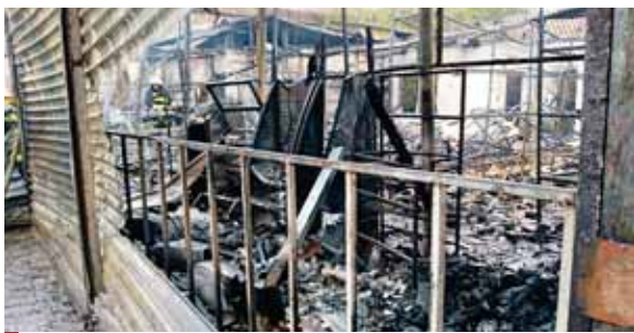
Según propietarios, las pérdidas fueron millonarias y tras el percance muchas personas se quedaron sin trabajo.
