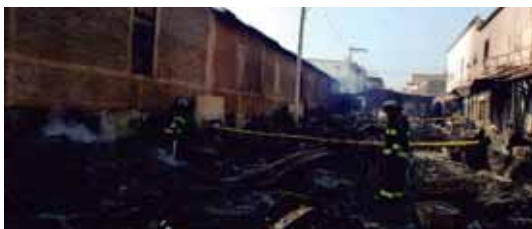
El lugar quedó reducido a escombros, luego de un incendio por más de tres horas.
