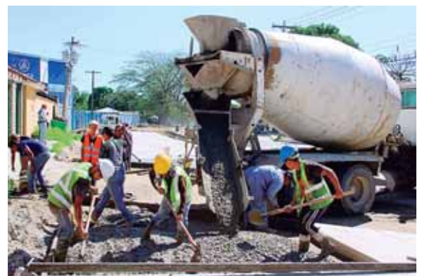
La obra comprende la pavimentación de 1.6 kilómetros, más la construcción de aceras y la señalización vial.
