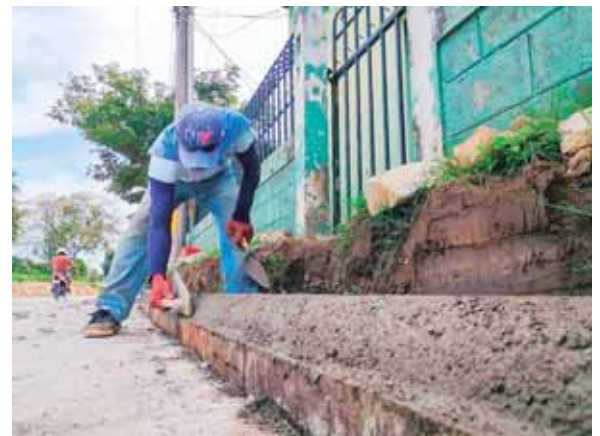
La obra, que se encuentra en etapa final, comprende de 630 metros lineales de pavimentación.
