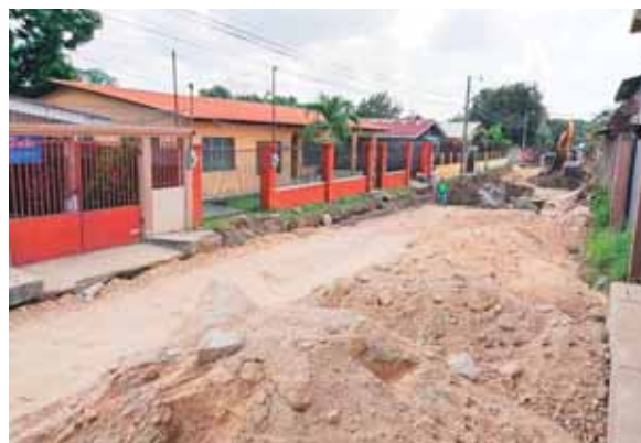
La longitud de la obra es de 465 metros lineales de pavimento. Hasta el momento se está trabajando con el relleno.
