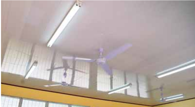
La escuela Lila Luz de Maradiaga ya lleva buen avance en la reparación de techos, los menores recibirán clases sin riesgos.
