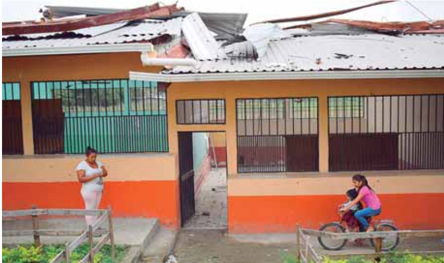
Desde el año pasado el techo de cinco aulas fue arrancado debido a los fuertes vientos, desde entonces han tenido que acomodar a varios grados en una sola sala.
