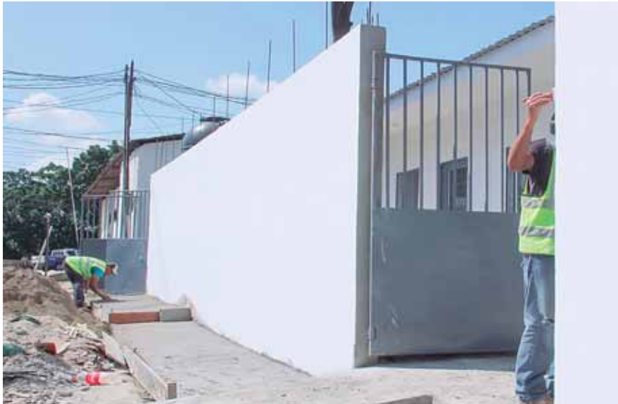
Una de las mejoras es la reconstrucción del muro perimetral. Éste es con el fin de brindar mejor seguridad a los visitantes que llegan para recibir atención médica.
