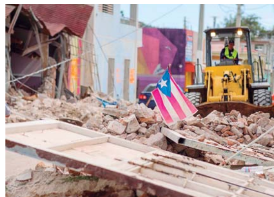
Autoridades limpian los escombros de los edificios caídos, producto del fuerte sismo que sacudió esta zona.
