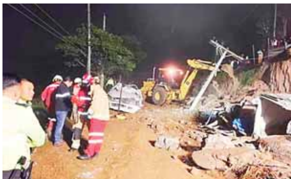
El percance ocurrió cuando cayó un muro de contención de hormigón armado de 30 metros de ancho por 5 metros de altura.
