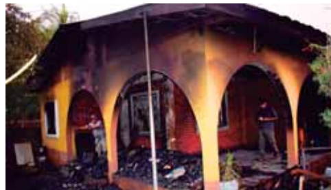
El interior de la vivienda fue lo que resultó más dañado, por lo que no se salvó nada.
