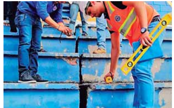
Una de las fisuras en la parte superior de la gradería del sol centro, el muro puede caerse en cualquier momento.
