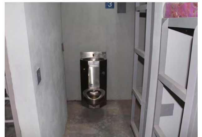
Cada celda cuenta con sanitario de acero inoxidable, las puertas son de acero y tiene candados codificados.
