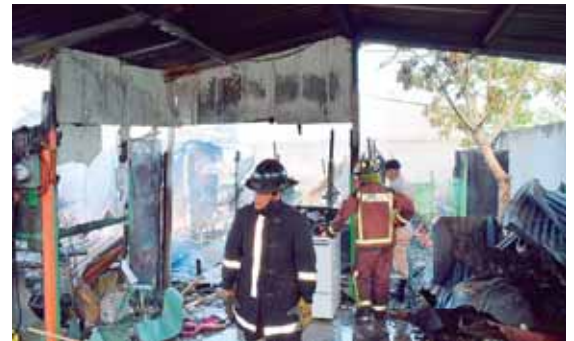
Las pérdidas de la vivienda fueron casi totales, ya que el material era altamente inflamable.
