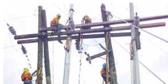
EEH continúa realizando mejoras cumpliendo con su compromiso de brindar mantenimiento a las líneas de distribución y así reducir las fallas en el servicio de energía eléctrica.
