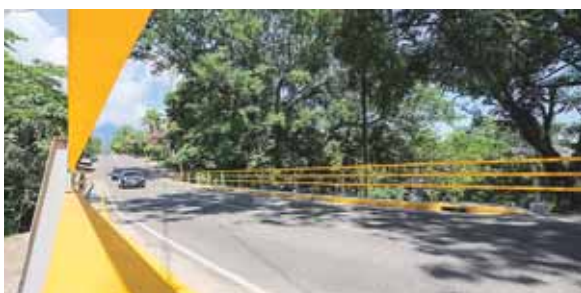
El puente tiene una longitud de 60 metros y cuenta con tres bases, donde se efectuaron las obras que protegen para evitar accidentes.
