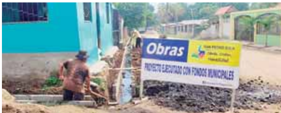
Con esta obra se mitigarán los problemas de inundación en esa importante zona de la ciudad.
