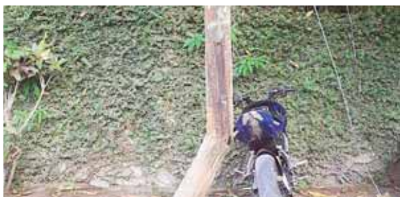
Vecinos denunciaron que son aproximadamente tres años que el poste de electricidad está en mal estado.
