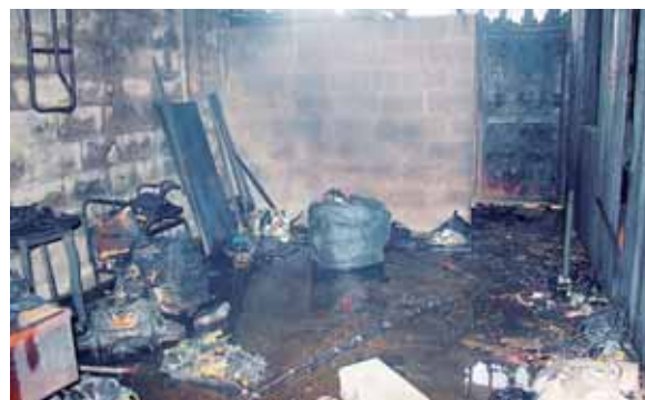
La mayoría de las viviendas reportaron pérdidas totales.
