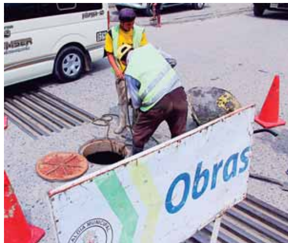
Estos trabajos son parte de las acciones que ejecuta la municipalidad para prevenir inundaciones durante la temporada lluviosa.
