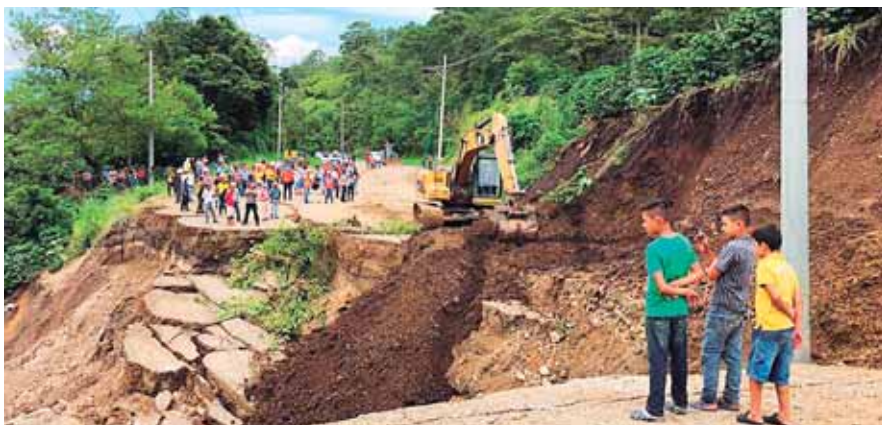
Las fuertes lluvias reactivaron esta enorme falla geológica y dejaron como resultado el corte del paso en el sector de Cucuyagua.
