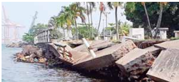
El malecón se construyó hace unas dos décadas, debido a desastres naturales se ha visto afectado.
