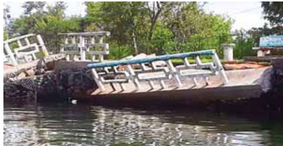
Desde hace cuatro años, el deterioro de esta estructura ha venido acelerándose.
