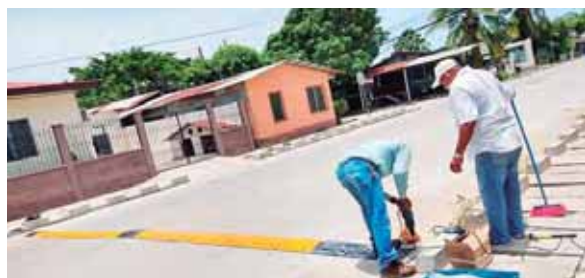
El patronato gastó más de 20,000 lempiras en esta construcción, con la que esperan disminuir los accidentes.
