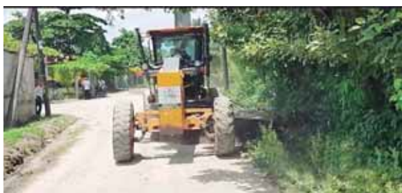
Desde el año pasado no se le daba mantenimiento a las calles.
