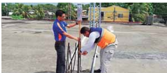
El aparato fue instalado por el personal de Copeco.
