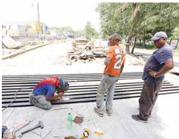
La obra tiene la capacidad de drenar 25 metros cúbicos de agua por segundo, por lo que fortalecerá el sistema pluvial.
