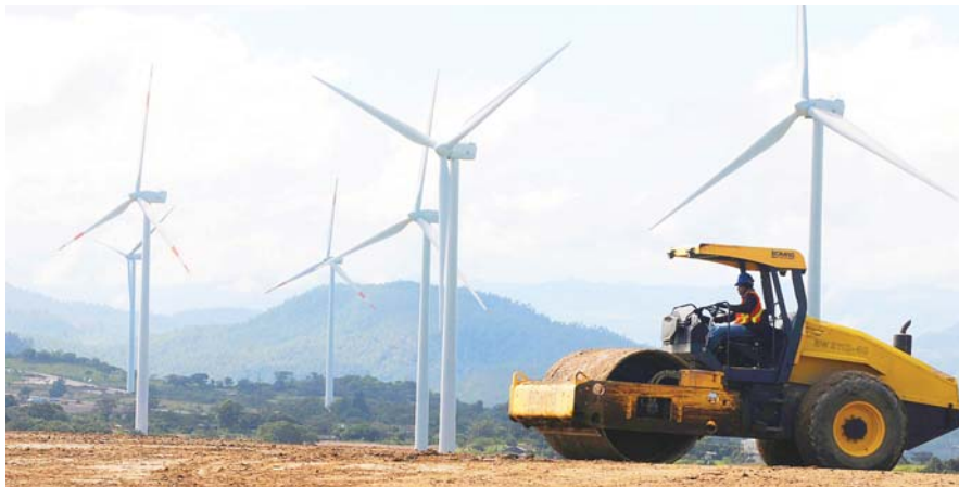
La generación de energía con métodos renovables ha sido impulsado en el país, logrando hasta ahora un gran aporte al sector eléctrico.
