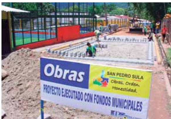
El adoquín que se está colocando tiene muy buena resistencia y filtración de agua.
