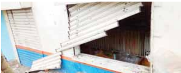
Esta es la fachada del Banasupro de la colonia 3 de Mayo. La cortina fue forzada.
