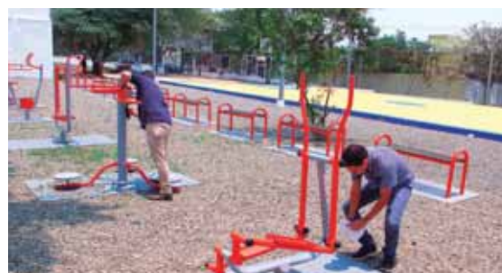
El proyecto se encuentra en etapa final y brindará alternativas de esparcimiento y sana convivencia.
