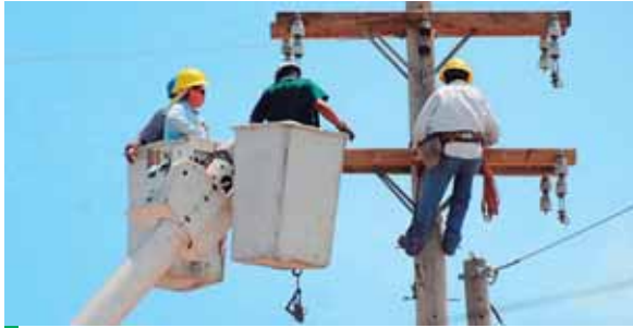
El personal de EEH realiza evaluaciones constantes en empresas y casas para detectar anomalías.
