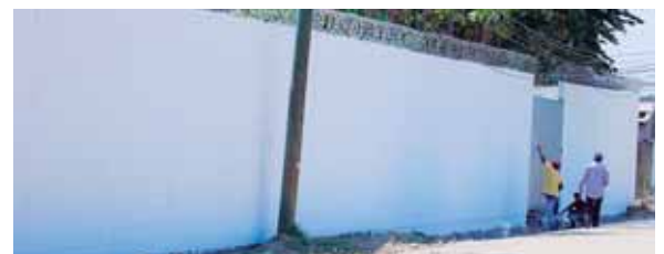
Con esta obra se benefician más de 400 estudiantes de ese centro educativo. Actualmente los empleados trabajan en pintar el muro.
