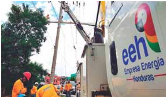
EEH ha estado gestionando e instalando equipos que permiten detectar irregularidades en el consumo de forma remota.
