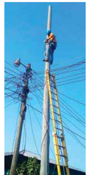
Los empleados de EEH revisan conexiones ilegales.
