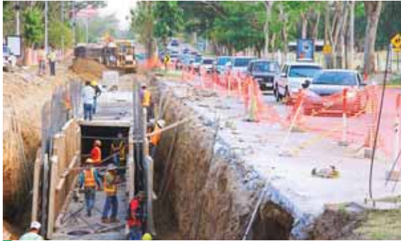
La intersección de la 13 avenida con el bulevar "José Antonio Peraza" estará cerrada durante 22 días.
