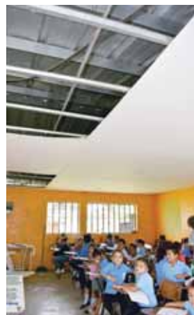
Reparar parte del techo es una de las necesidades que tienen.
