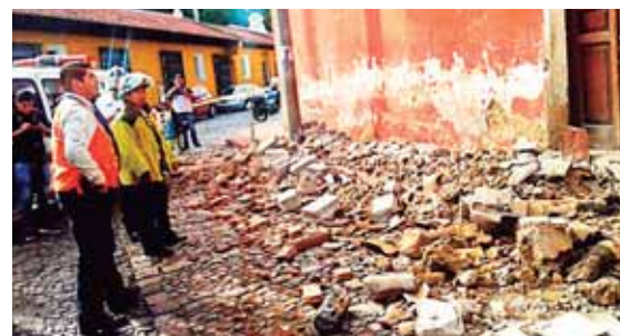
El temblor causó derrumbes, heridos leves y daños en infraestructura.
