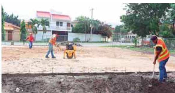
La obra que se está ejecutando en la colonia Covimal avanza en un 55 por ciento.
